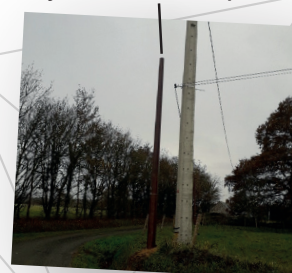
Poteau neuf Mayenne Fibre implanté
